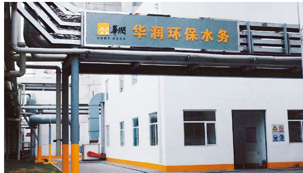
▲ 华润环保水务在山东菏泽污水处理厂的污泥焚烧处理处置项目，利用华润纺织和华润电力内部协同优势，集污泥接收、储存仓及配套污泥输送设备为一体，将污水处理厂的污泥通过专用运输车运输至电厂，通过卸料斗及输送皮带将污泥转移至地上污泥仓内，再通过皮带、斗式提升机等设备将污泥仓内的污泥输送至电网上煤皮带上。
