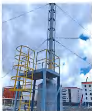
图 4-5 污水处理站废气处理设施及排放口
